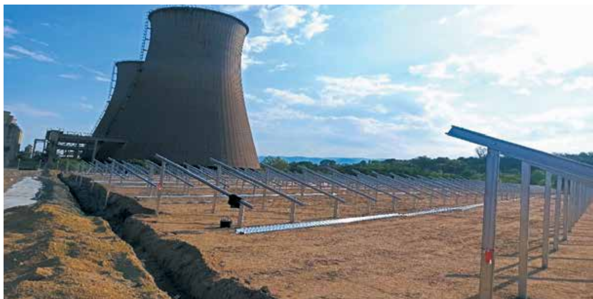
Εγκατάσταση φωτοβολταϊκού συστήματος 1 MW και ανάπτυξη υποδομών πράσινου υδρογόνου στο εμβληματικό έργο της μεταλιγνιτικής εποχής.
